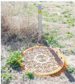
Marcas de Tapas de Bocas de Inspección/ Acceso
